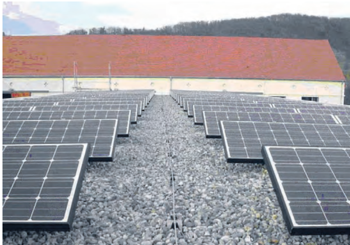
Bürgersolkraftwerk auf dem Dach der HTW.
